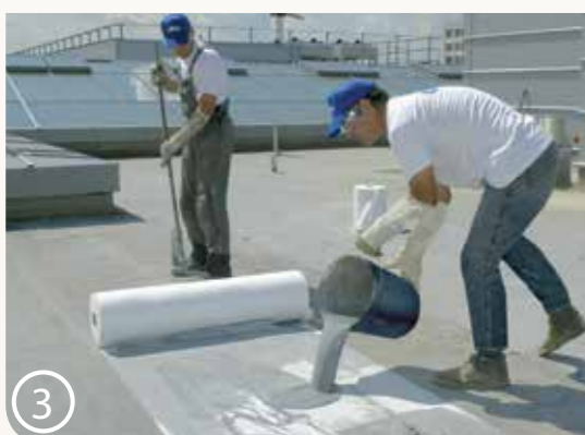
3 La seconda mano di resina KEMPEROL® è applicata, a prima mano ancora liquida, sul tessuto per saturarlo di resina
